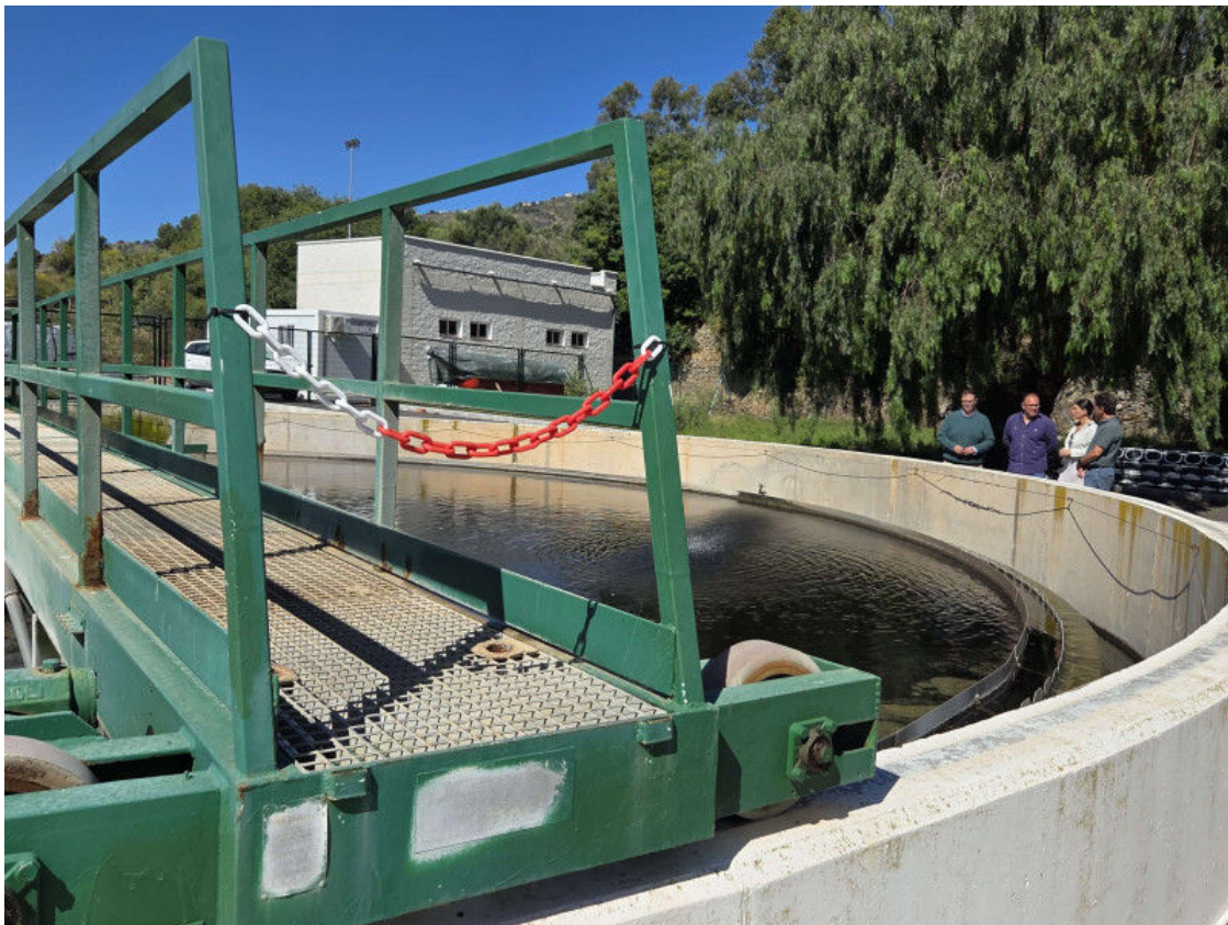
Sistema de aireación en la EDAR de La Herradura
